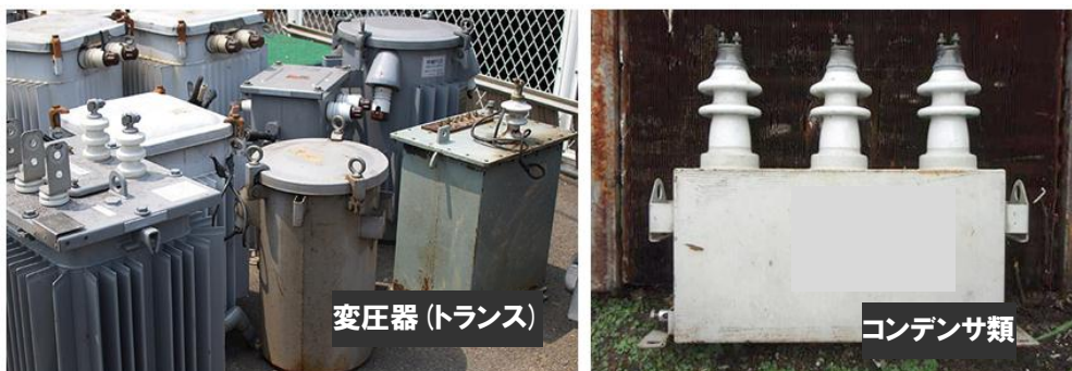
写真-6.5.1 PCB を含有する可能性がある電気機器（変圧器・コンデンサ類）の例
