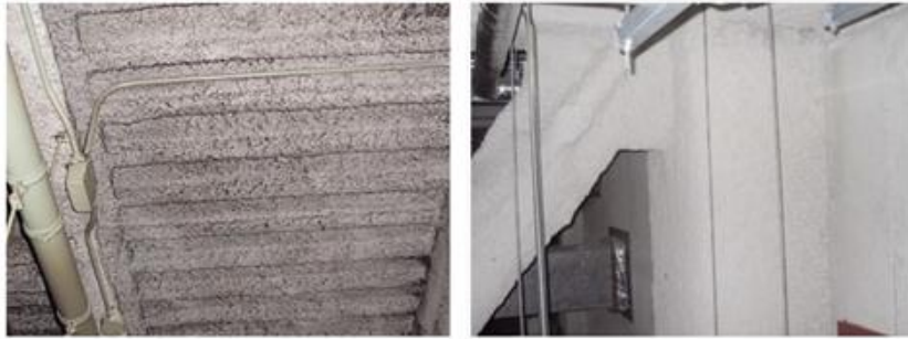
写真-6.5.2 アスベスト使用箇所例（石綿含有吹付け建材・ロックウール）
